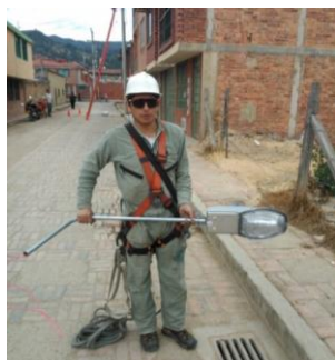
Foto 13. Cambio de luminaria pública municipio de Ubaté
