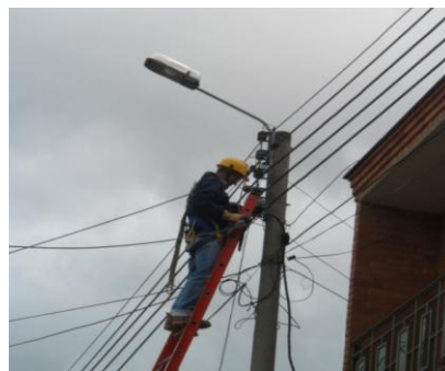
Foto 14. Cambio de luminaria pública municipio de Ubaté
