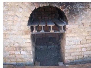
Vista frontal hogar de alimentación de combustible
